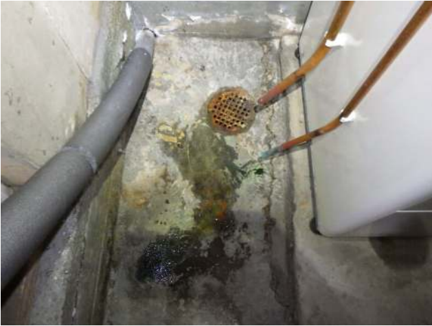
28. Pannuhuoneen lattia ja lattiakaivo
