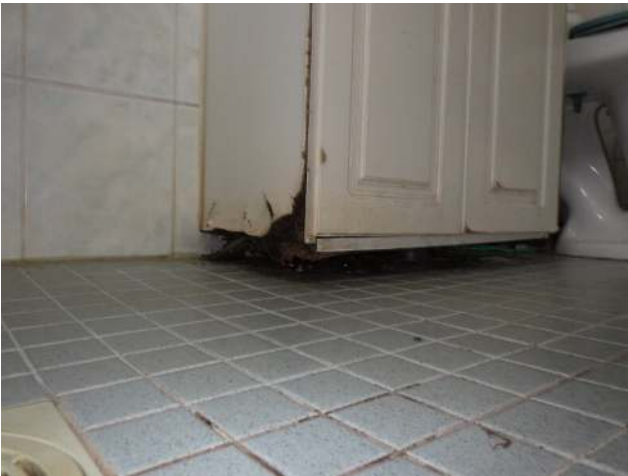
20. Allaskaappi on vaurioitunut
