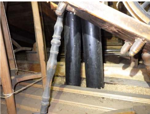
17. Eristämättömät ilmanvaihtokanavat yläpohjatilassa
