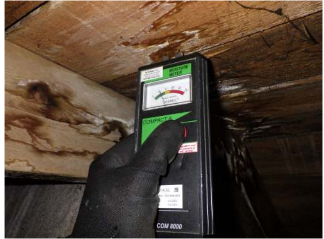
16. Savupiipun ympäröivien rakenteiden vuotojäljet ja puun kosteusmittausta
