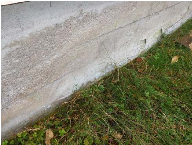
1. Sokkelissa on kosteuden nousun jälkeä
