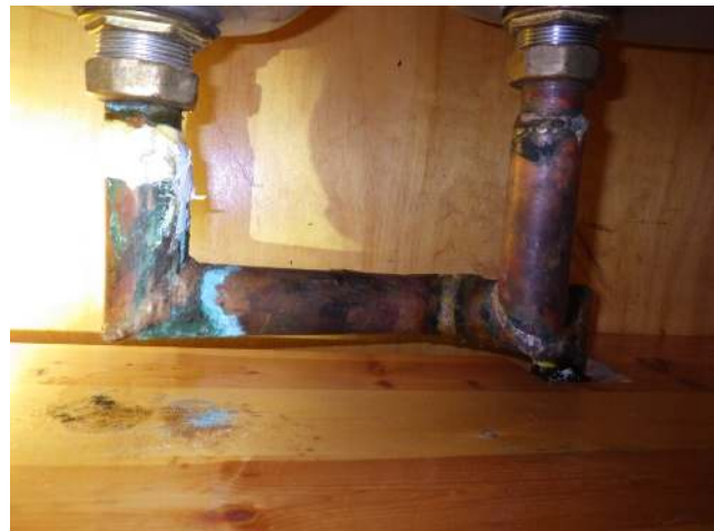
40. Keittiön allaskaapin viemäriputket
