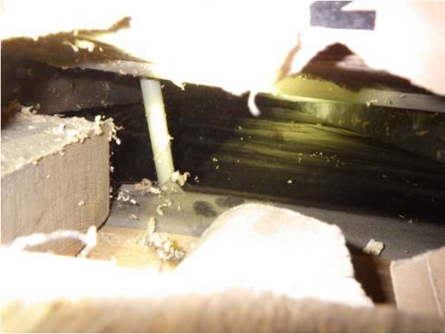
15. Väliseinästä puuttuu eristeet
