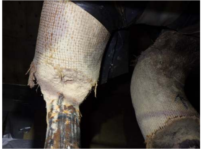
29. Putkieristeet voivat sisältää asbestia
