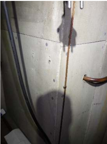
30. Pannuhuoneen verhoulevyit voivat sisältää asbestia
