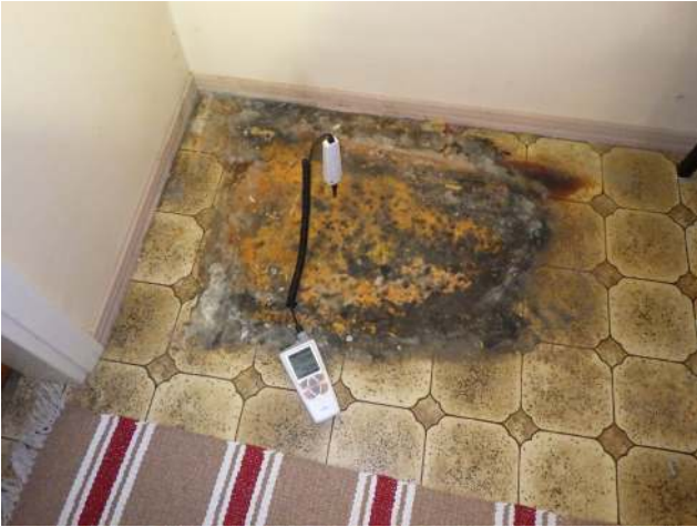
25. Keittiön lattian kosteusjälki ja suhteellisen kosteuden mittaus
